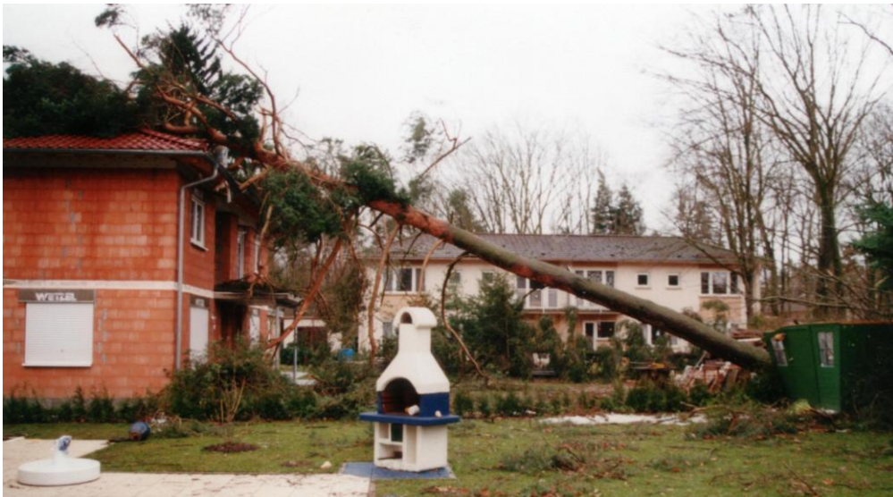
Bild 1: Ein infolge des Orkans „Lothar“ auf ein Wohnhaus gestürzter Baum; teilweise herausgerissener Wurzelstock, Schäden am Dachstuhl
